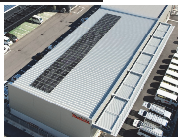
岐阜支店の屋上に設置された 太陽光パネル
