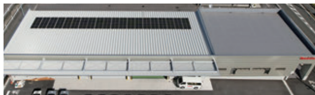
▲岐阜支店の屋上に設置された太陽光パネル
