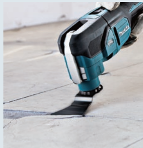
Pタイルの剥離
